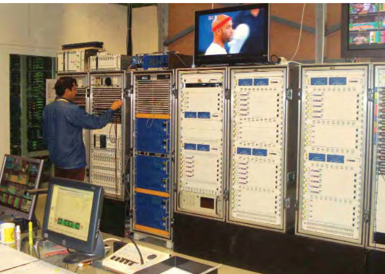
Switching Center de EBU en Beijing con equipos Impact, Course y BC-2000 D. Operando el ingeniero de RNE D. Javier Ferreras
